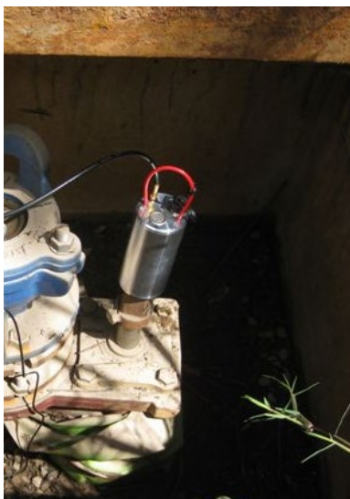
図25バルブスピンドルに取付けられた「A」センサー
