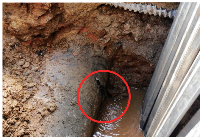
▲実際に発見した漏水箇所(口径1000mm)
