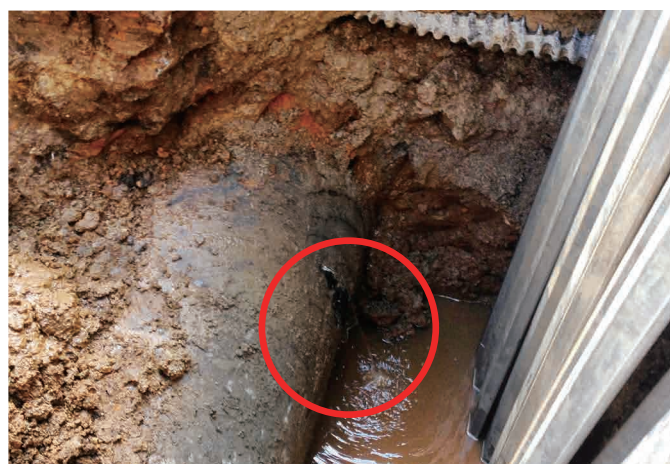
▲実際に発見した漏水箇所(口径1000mm)
