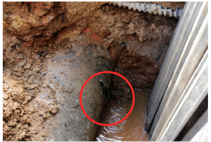
実際に発見した漏水箇所(口径1000mm)
