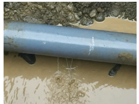
▲実際に発見した漏水箇所 (PVC管φ100mm)
