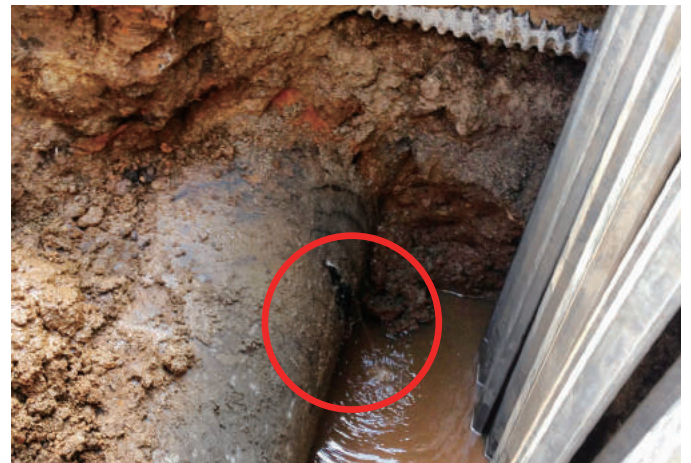
▲実際に発見した漏水箇所(口径1000mm)
